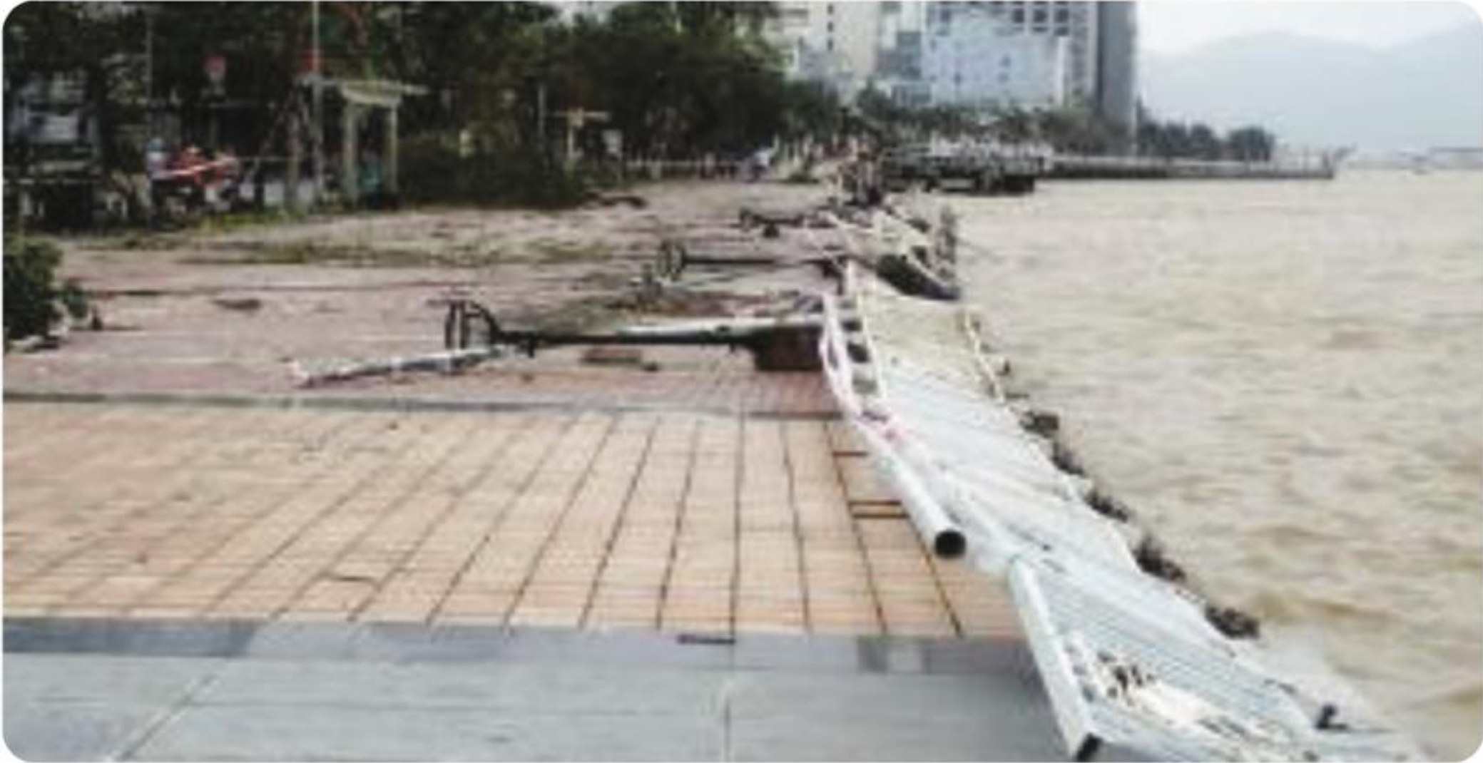
Hình 5.2. Bão số 11 năm 2013 làm đổ lan can đường Bạch Đằng, Đà Nẵng
