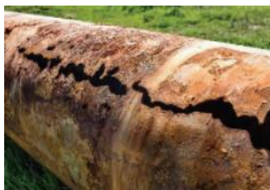
Đường ống dẫn nước bị hư hỏng
