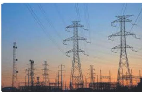
Đường dây điện cao thế
