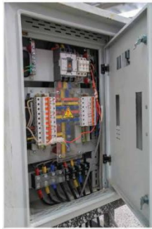
Hình 6.4. Bên trong một tủ điện phân phối
